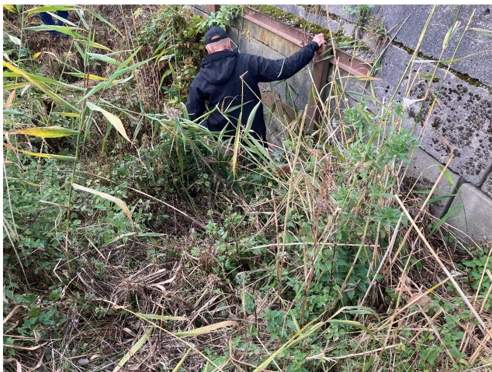
Figur 3-13 Broen ved Åserødveien. topp rør er synlig under veien, og det er tydelig at vann fra stormdiket kan drenere ut. Kapasiteten på dreispunktet er imidlertid begrenset, røret slutter ved broen, hvor vannet må passere i kulvert, for igjen å bli ledet inn i rør nedstrøms broen.
