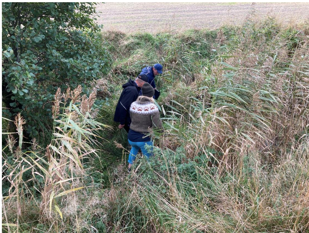
Figur 3-11 Bildet viser igjengroing og dybde under terreng på rundt 2 m for flomdiket.
